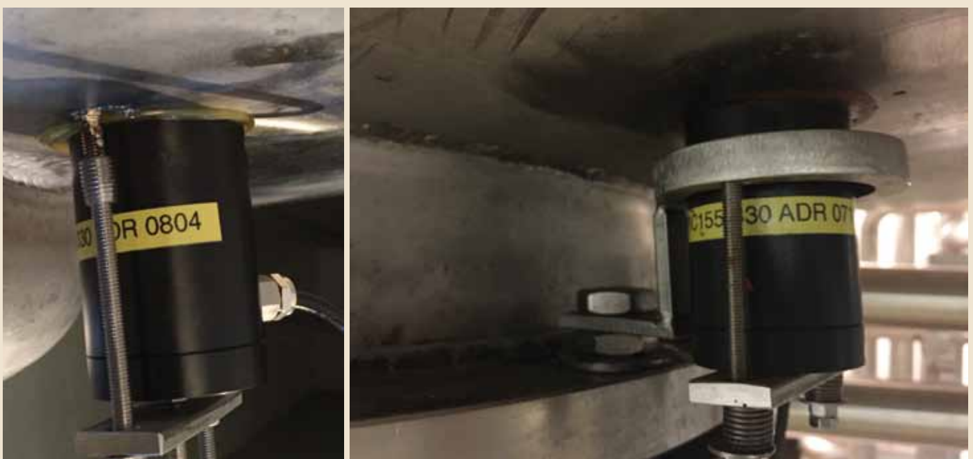
Abb. 1 Mechanische Befestigung der Ultraschallsonde direkt am Tankboden
